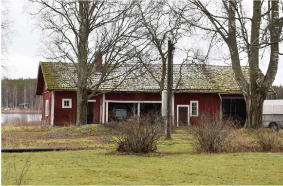
Kuva: Meijerinäkin toimineessa hirsi- ja lautarakenteisessa ulkorakennuksessa on runkovaurioita.
